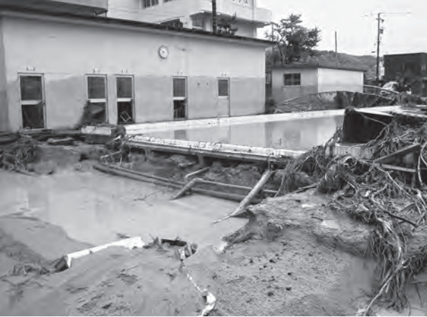
図21 東浅川小学校のプール (9:44撮影) 手前にあったコンクリート製の塀と床と水道設備は、隣接する工場 (図20) へ流された。
