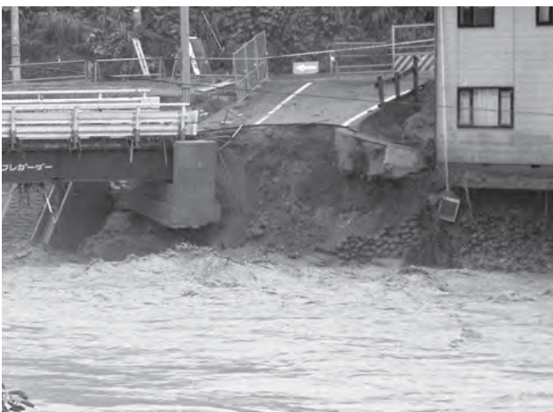
図37 銚子口橋のたもと (10:27撮影) 川沿いの道路が流失し、基礎の下をえぐられた住宅が宙に浮いた。
