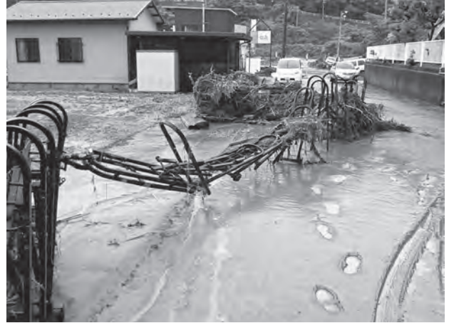
図22 東浅川小学校の入口周辺 (9:38撮影) 金属製の矢来垣が水流で引き伸ばされた。
