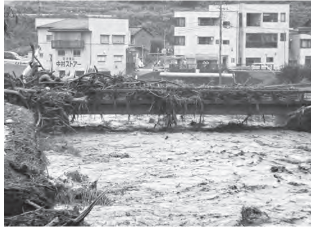
図28 田倉橋 (8:59撮影) 大形流木と草が橋上に山のように積み上がった。
