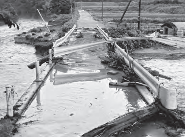
図9 袋板屋橋 (9:19撮影) 水流で橋上のフェンスが折れ曲がった。
